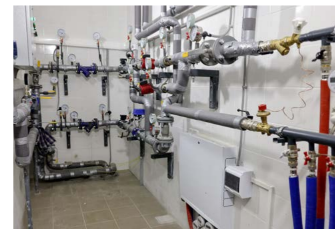
Приборы учёта воды и тепла находятся в отдельном помещении на этаже, все счётчики - с возможностью дистанционной передачи показаний
