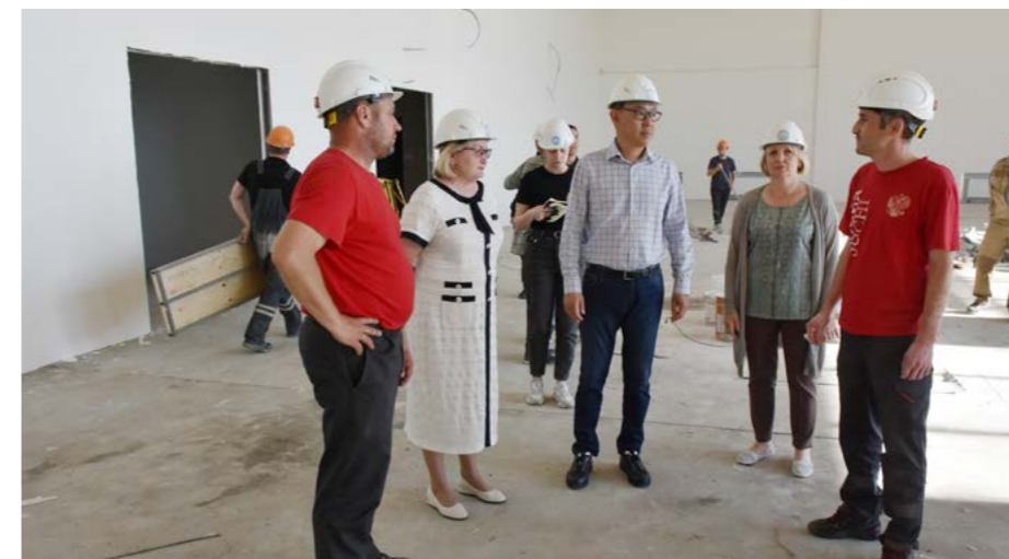
Глава района Виктор Югай оценил темпы строительства новой школы на 800 мест в Тазовском
