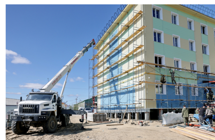
На стройплощадке самого крупного дома из тех, что сейчас возводят в райцентре, подрядчик - строительное объединение «Арктика» - параллельно занимается внутренней отделкой и благоустройством
