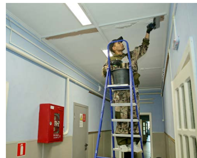
В коридорах Тазовской школы искусств устраняют последствия протечки крыши
