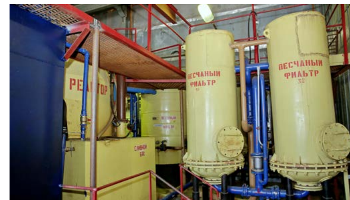
Старые очистные сооружения тоже ждёт модернизация: пока в эти фильтры засыпан песок, но скоро его заменит современный материал
