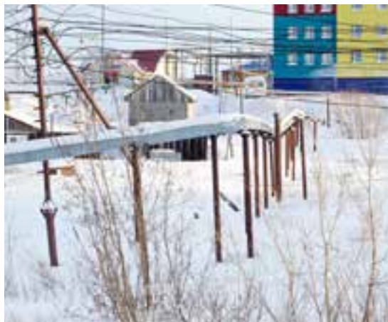
Неработающие канализационные сети в центре посёлка
