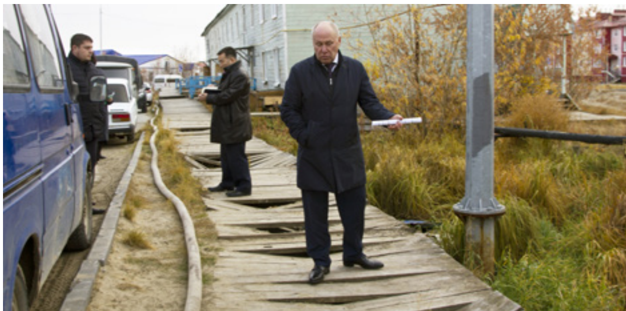
Глава посёлка и представитель управляющей компании пообещали устранить замечания, в том числе по ремонту деревянных тротуаров
