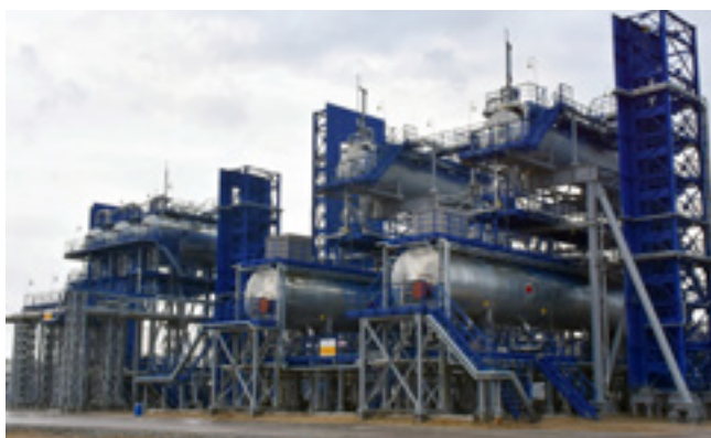
Электродегидратор на центральном пункте сбора. Именно здесь проходит процесс подготовки сырья к дальнейшей транспортировке
