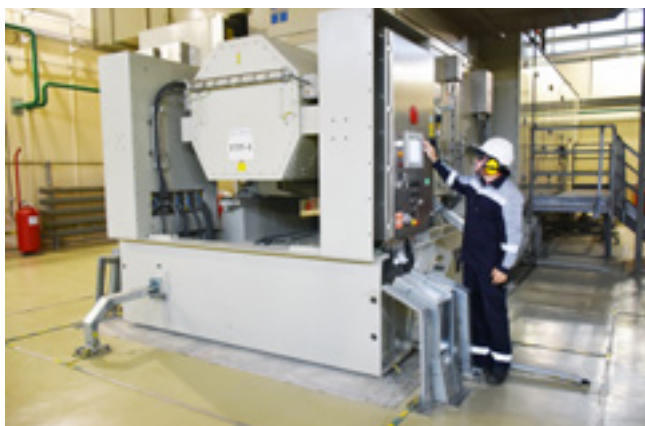
Газотурбинная электростанция. Она оснащена шестью турбинами общей мощностью 84 МВт. ГТЭС обеспечивает электроэнергией все объекты промысла
