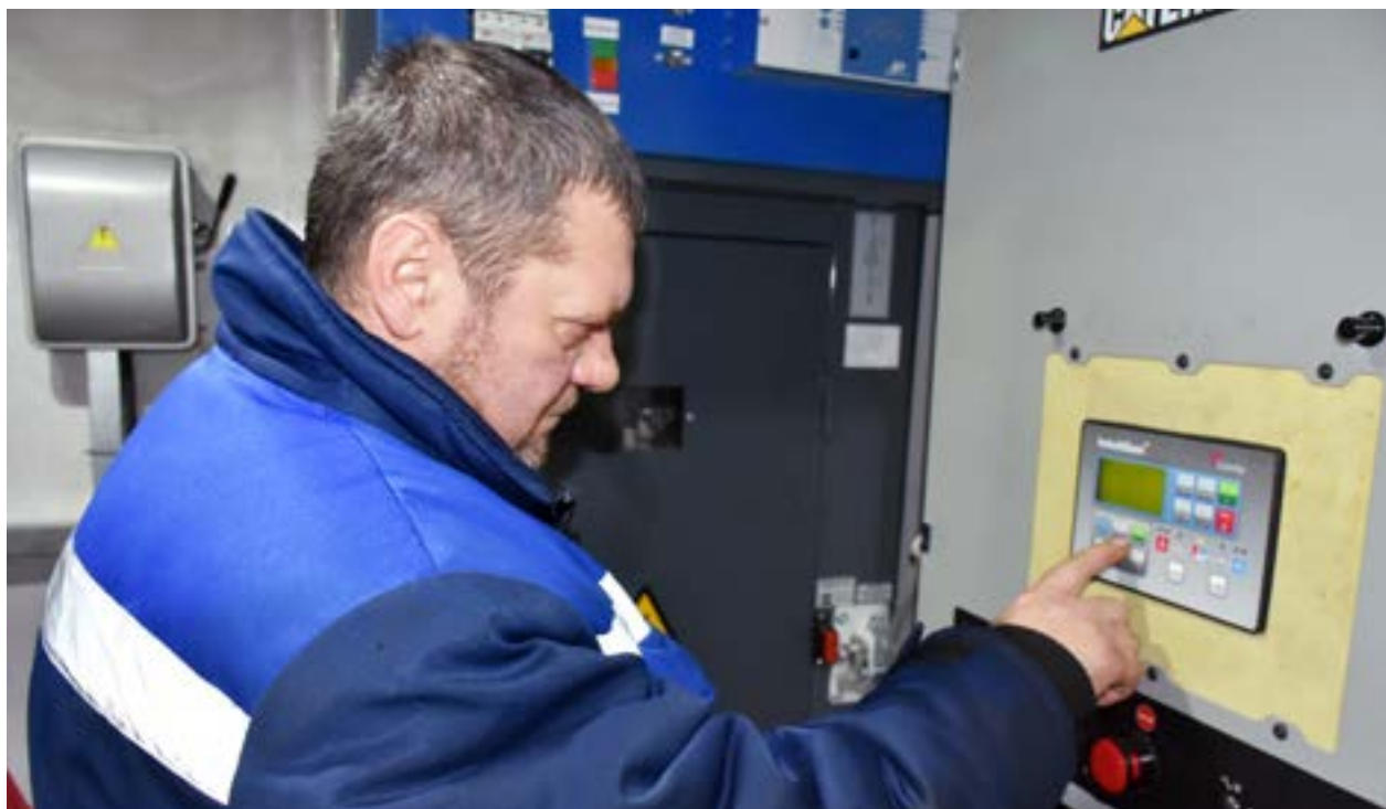
Павел Саев - ма- шинист электро- станции
