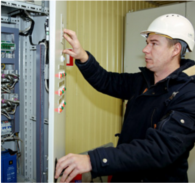
Начальник цеха электроснабжения посёлка Олег Карайбида хоть и вспоминает с ностальгией старые двигатели АИ-20, но всё же работать удобнее с новым оборудованием
