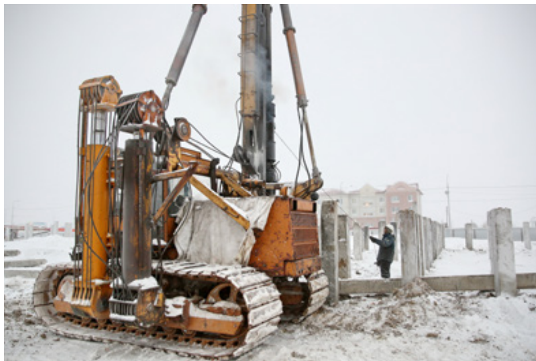
Специалисты Северной строительной компании забивают сваи в основание первых двух четырёхэтажек нового микрорайона
